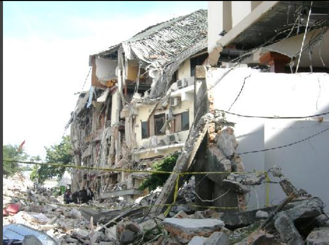
Pengalaman kerusakan gedung hotel akibat gempa Padang tahun 2009
