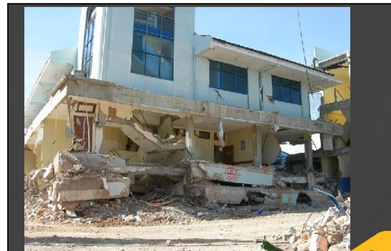
Pengalaman kerusakan gedung pendidikan akibat Gempa Padang tahun 2009
