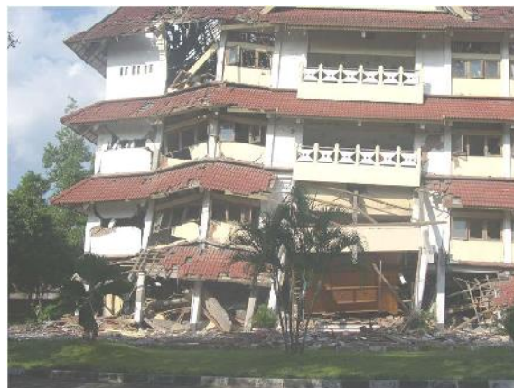
Gambar 1 Kerusakan bangunan akibat gempa Yogyakarta tahun 2006
