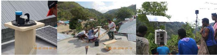
Gambar 28. Pemasangan sensor pengukur curah hujan di dusun dan di gunung
