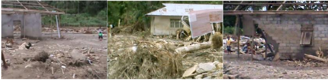
Gambar 5. Kerusakan akibat banjir tgl. 1 Agustus 2012 di Dusun Nasiri
